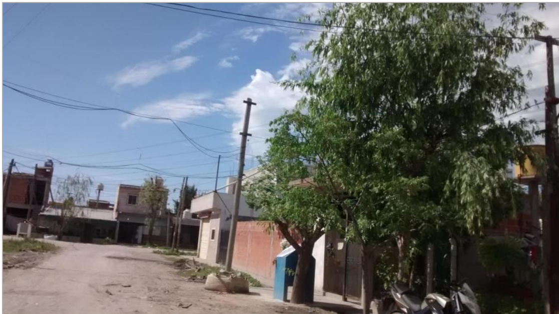
Imagen 20 Tendido eléctricos domiciliarios a baja altura
